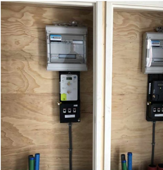
Kantoor, binnenzijde meterkast
