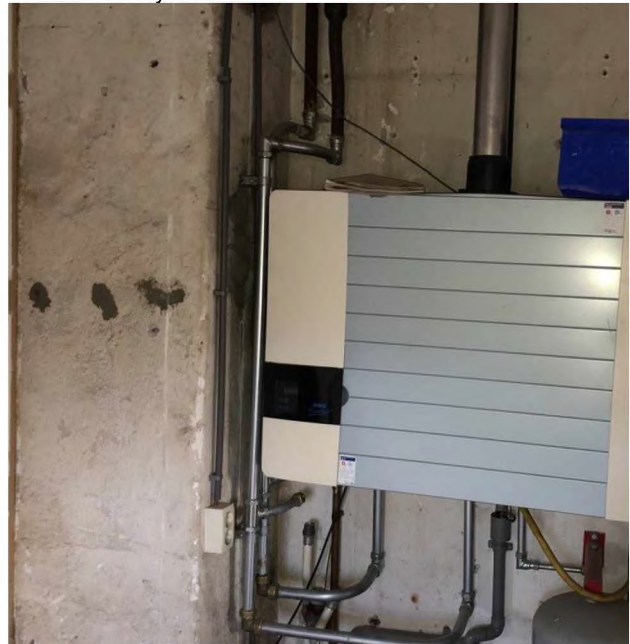
C.v. installatie verdieping
